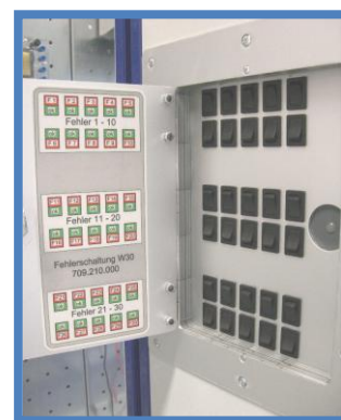
Abschließbare Fehlerschaltung für bis zu 30 Fehler
